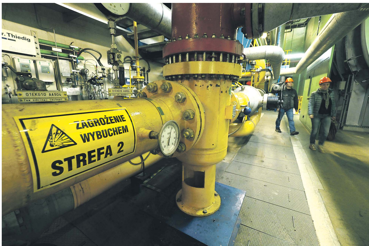
Elektrociepłownia na Wrotkowie jest największym w mieście wytwórcą energii cieplnej
