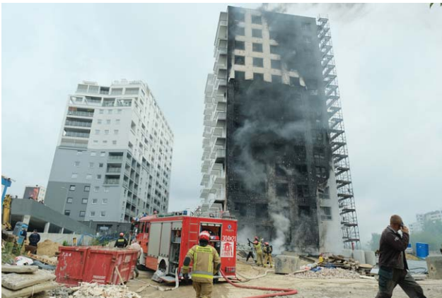
Wielki słup czarnego dymu pojawił się nad Lublinem we wtorkowy poranek. Zapaliła się elewacja jednej ze ścian budowanego wieżowca FOT. MACIEJ KACZANOWSKI
