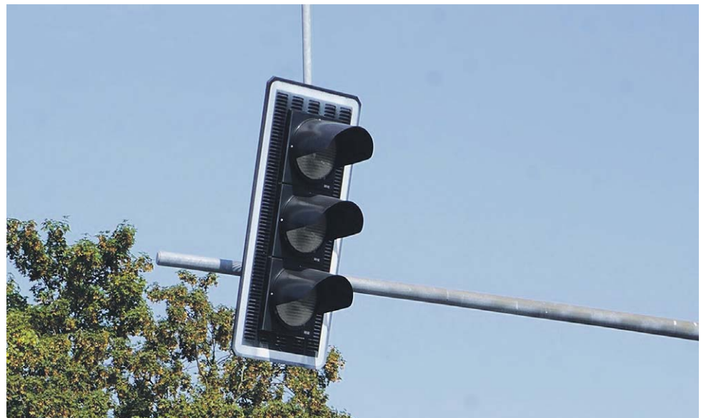
ŚWIATŁA Problem z gasnącymi sygnalizatorami trwa od lata tego roku. Według władz wojewódzkich przyczyn jest wiele, od stanu instalacji elektrycznej, wysłużone podzespoły, zwarcia po uszkodzenia mechaniczne
