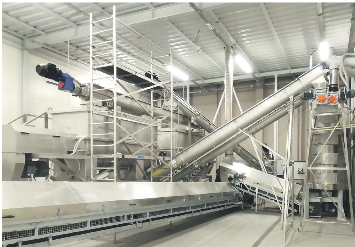
Instalacja do higienizacji komunalnych osadów ściekowych w Oczyszczalni Ścieków „Hajdów” powstała w 2024 r.
