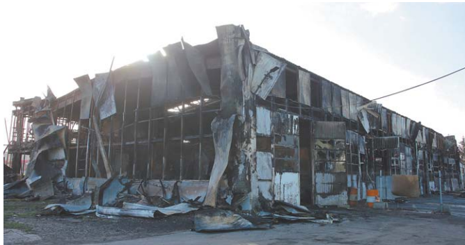
Mimo wysiłków 103 strażaków, hala nadaje się do rozbiórki
