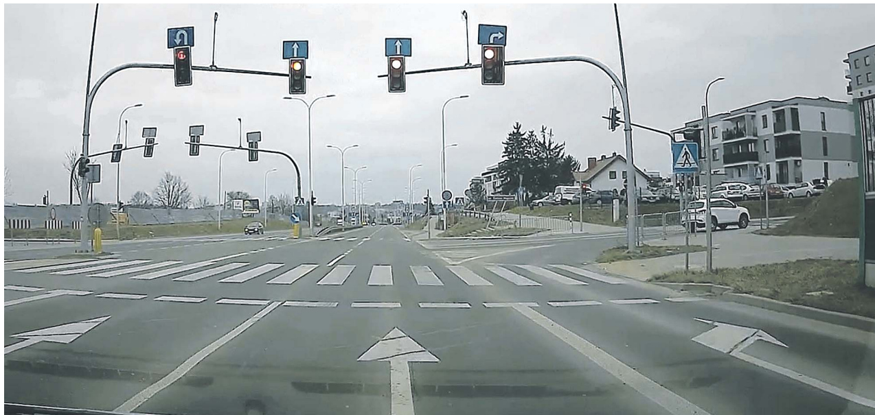
Skrzyżowanie ul. Poligonowej z ul. Zielone Wzgórze nie jest włączone do miejskiego Systemu Zarządzania Ruchem, a pracę sygnalizacji świetlnej reguluje tutaj niezależny sterownik
