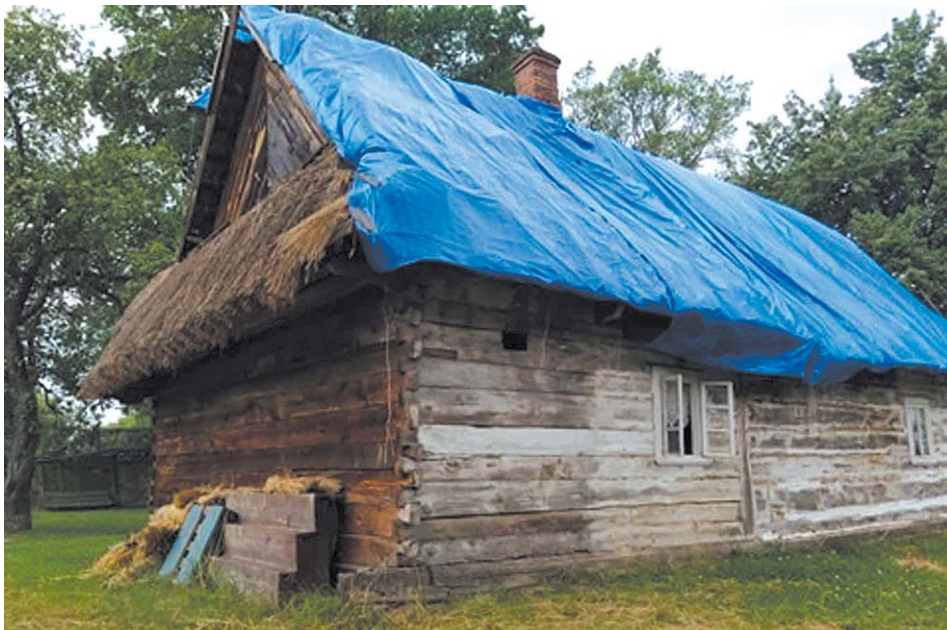
W lipcu burza zerwała strzechę oraz zalała zabytkową XIX-wieczną chałupę, która przykryta niebieskim brezentem czeka na efekt zbiórki
