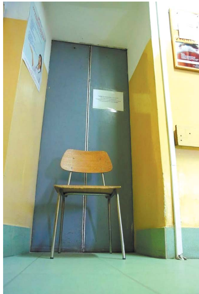
Winda wciąż nie działa. I wciąż zastawiona jest krzesłem
