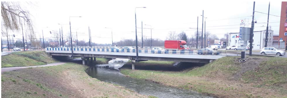
Most w al. Unii Lubelskiej jest tak osłabiony, że konieczne było zamknięcie jednego pasa ruchu i zaostrożenie ograniczeń tonażowych
