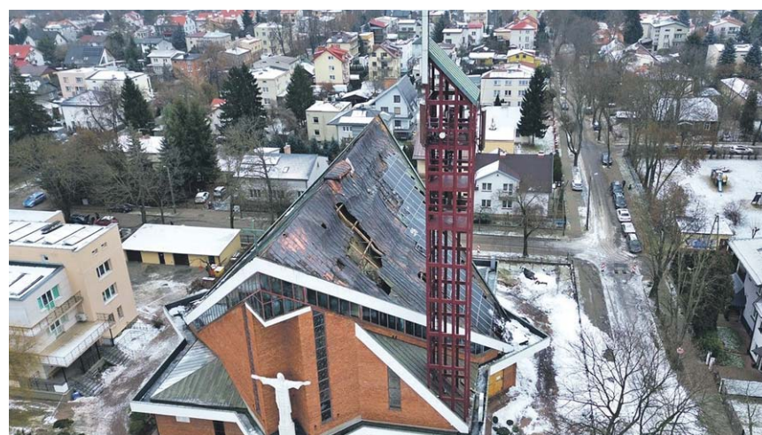
Widok z góry na zniszczony ogniem dach kościoła przy ul. Kunickiego
